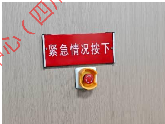
墙面紧急停机按钮
